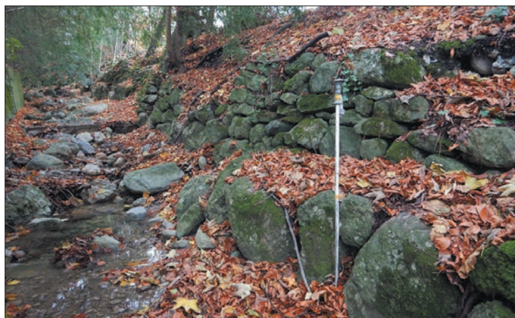
Schutzdamm mit Blöcken (südliches Ufer) im Gebiet Lohri. Der Damm ist in einem schlechten baulichen Zustand.
