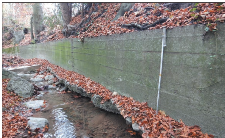
Ufermauer entlang des Rubibachs (südlich) im Gebiet Lohri. Die Fundation ist unterspült. Blick bachaufwärts.
